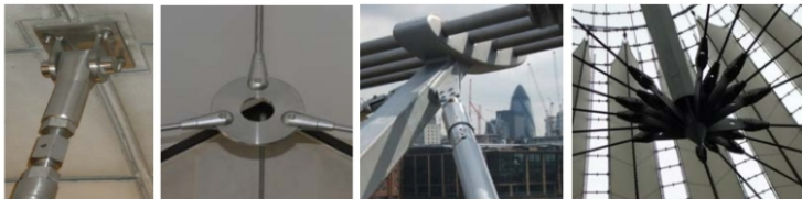
Figura: Uniones de Cables.
