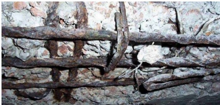
Figura 2.5: Efectos en el sistema hormigón armado
