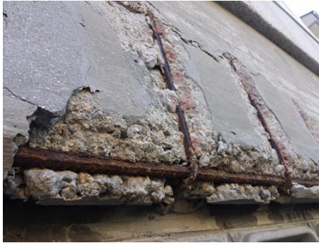
Figura 1.2: Corrosión en estructuras de concreto armado
